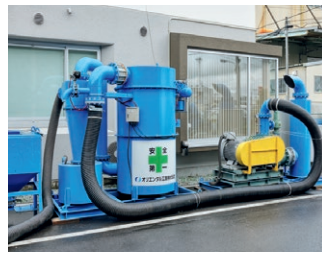
2 バキューム 回収機
